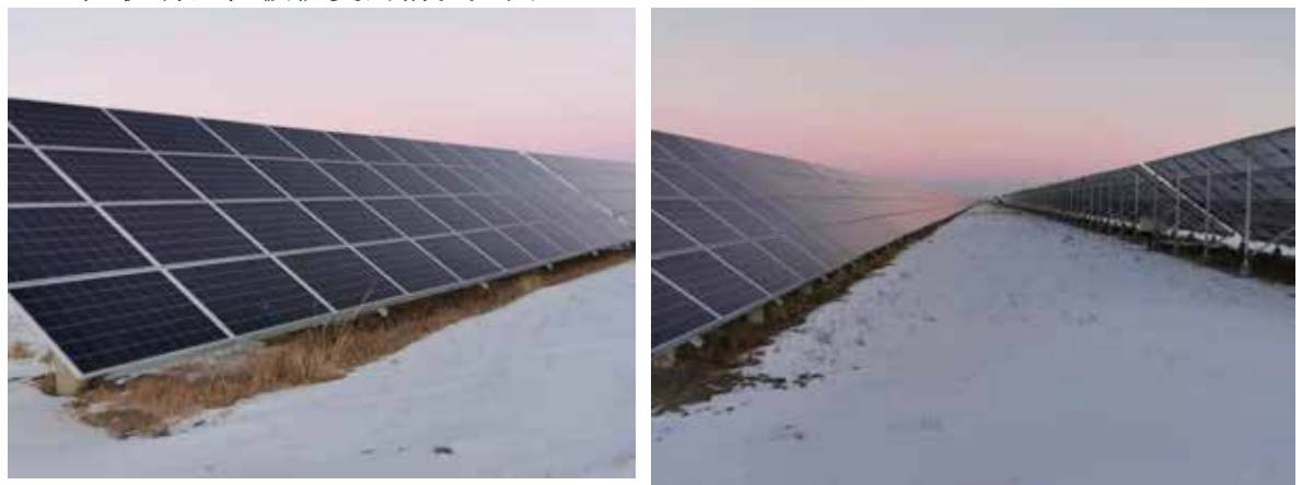
图6 植被恢复的光伏场区
