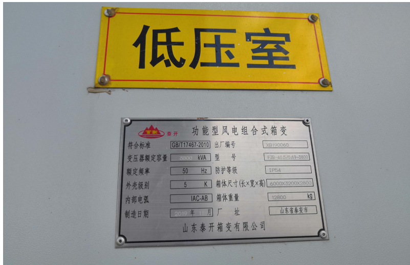
3.4MW风机对应箱式变压器铭牌
