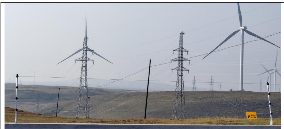
35kV进线6回构架
