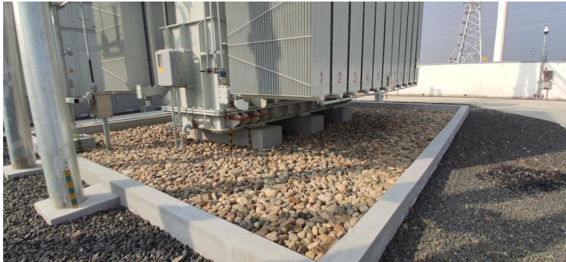
主变基础及事故油池
