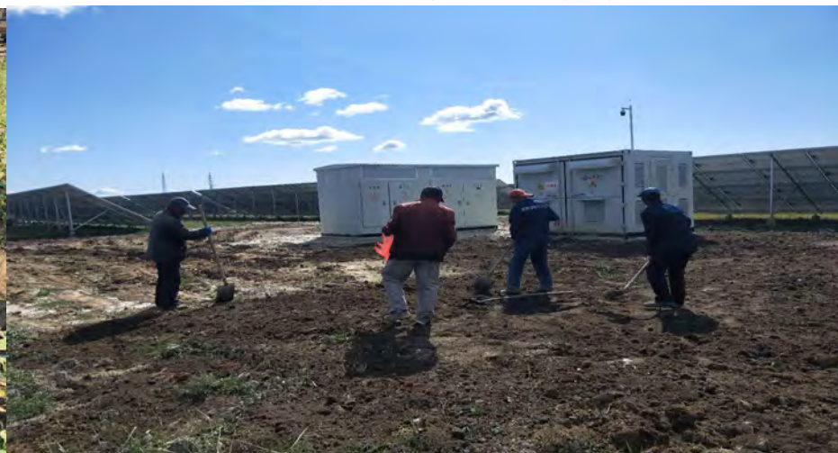
光伏阵区箱变播撒草籽 2010 年 6 月
